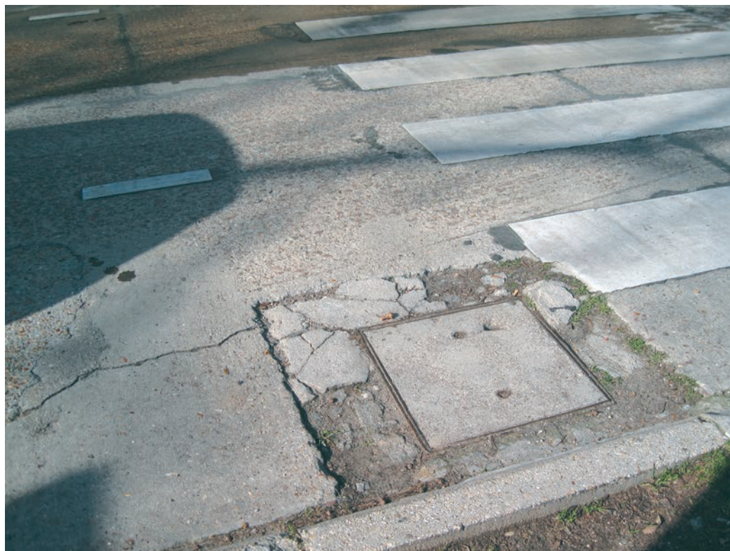
Fig. 1 Esempio di strada cementizia ammalorata
