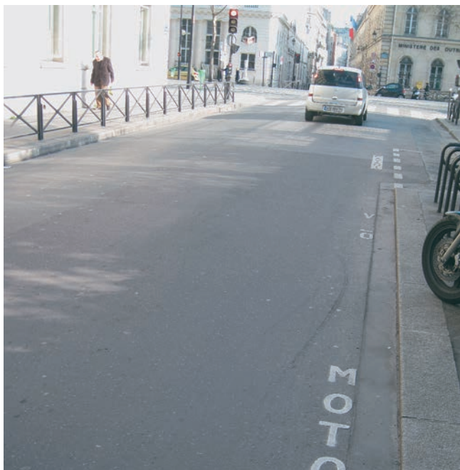
Fig. 4 Rue Eblé dopo venti anni dal ripristino con strato asfaltico
