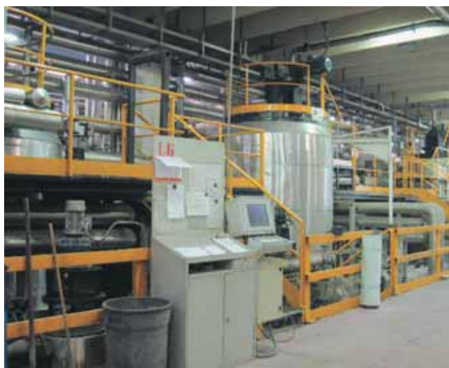
Fig. 11 Impianto per la produzione delle membrane
