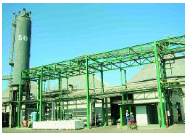
Impianto di confezionamento del bitume ossidato della Alma Petroli spa (Ravenna)
