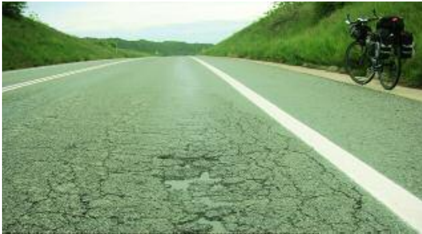
Fig. 10 Esempio di cattiva manutenzione
