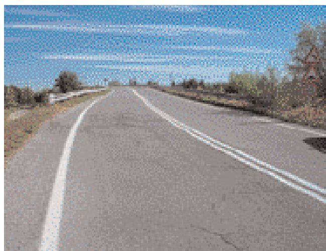
Fig. 1 Ammaloramenti sulla circonvallazione sud di Crema
