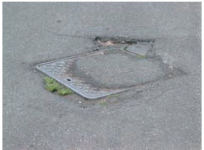
FIG. 5 Chiusini "annegati" nell'asfalto
