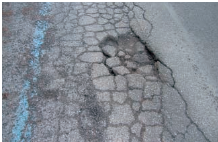
FIG. 3 Rottura tipica a "pelle di cocodrillo"
