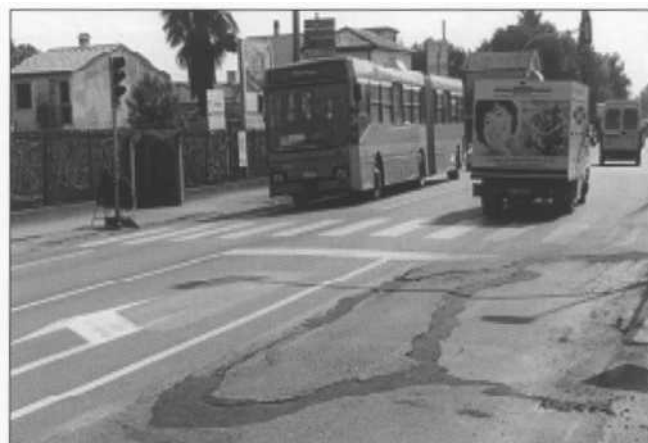
Fig. 1- Ammaloramenti su strada statale
