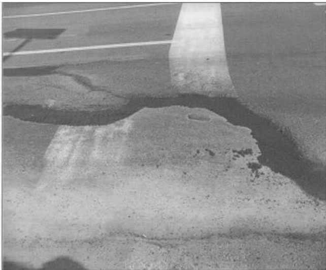
Fig. 3 - Un particolare del manto
