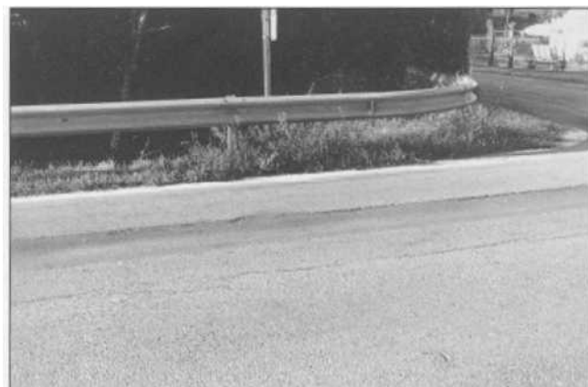
Fig. 8 - Grave ammaloramento della superficie
