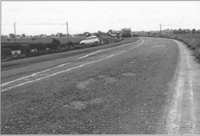
Fig. 2 - Fenomeno di ammaloramento in fase avanzata
