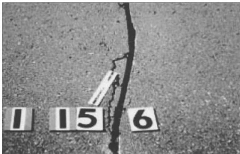
Fig. 1 - Incisione della fessura
