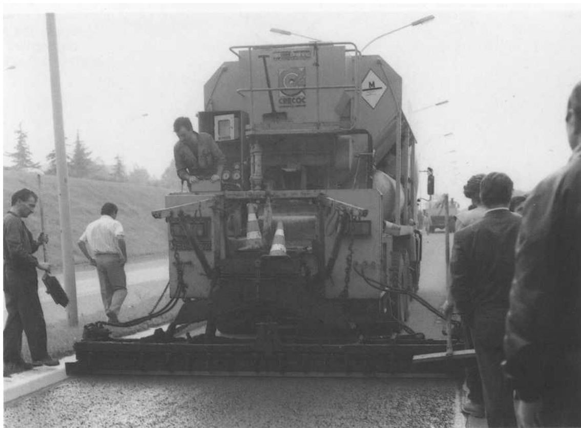
Figura 10. Sopralluogo dei partecipanti al Convegno sul Microtappeto Slurry-Seal ad una applicazione in corso sull'Asse Sud-Ovest di Bologna.
