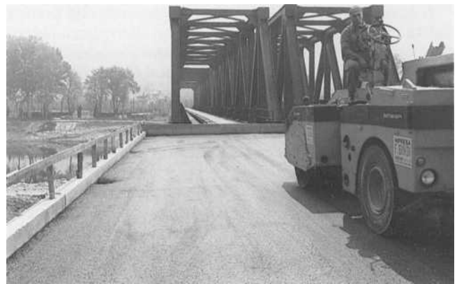
Fig. 12. 1° Lotto. Cantiere di stesa del conglomerato bituminoso completo di vibrofinitrice, rullo gommato e rullo metallico.
