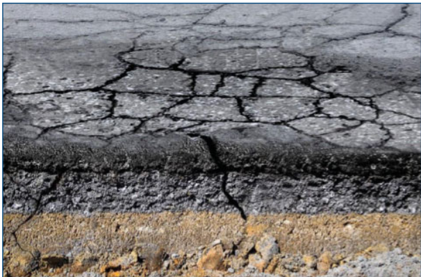
Fig. 2 Esempio di pavimentazione ammalorata
