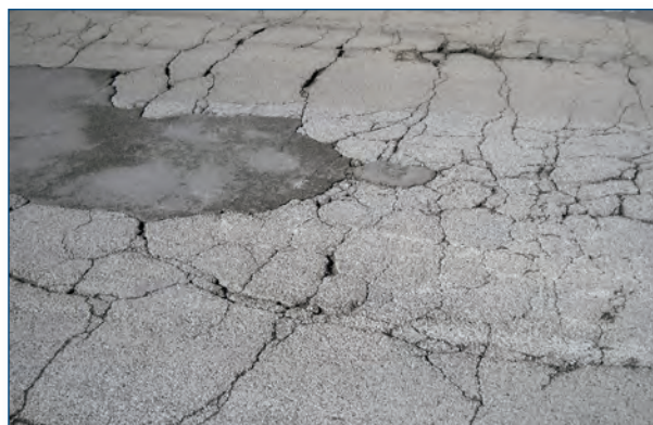
Fig. 1 Eccesso di fessurazioni
