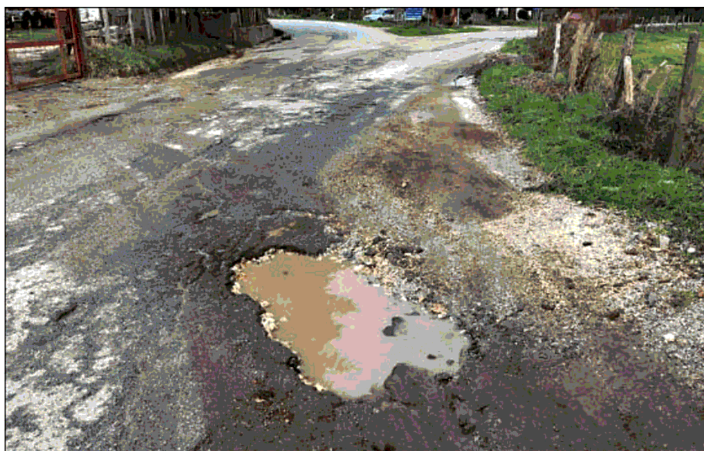
Le precarie condizioni in cui versano le strade del comprensorio delle Serre
