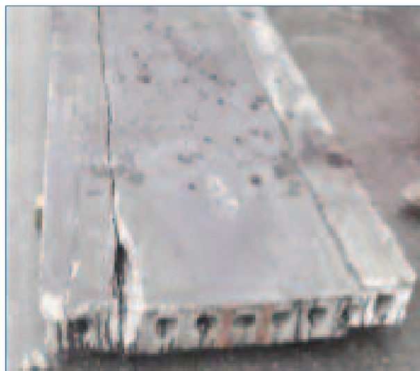
Fig. 5 Aspetto superficiale delle lastre di calcestruzzo ricoperte e non dal conglomerato bituminoso
