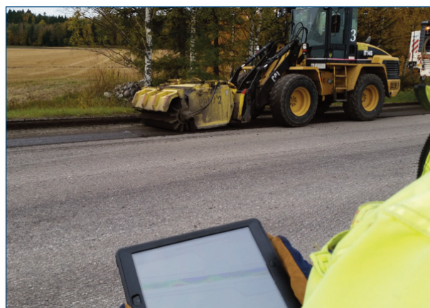
Fig. 9 Fase di lavorazione gestita attraverso il controllo digitale basato sul modello parametrico del profilo trasversale
