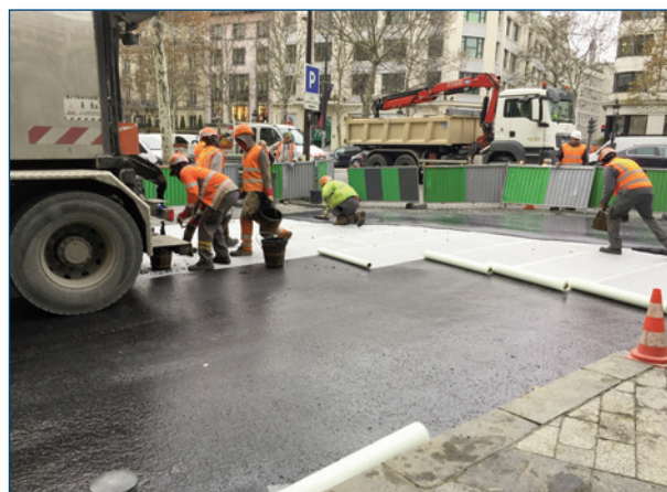
Fig. 1 Stesa di un doppio strato di asfalto colato in via Washington alla confluenza con i Campi Elisi
