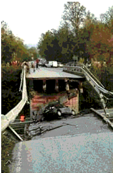
Il cavalcavia crollato. L'auto che viaggiava sopra rimasta in bilico. Sotto, invece, quella schiacciata dal cedimento
